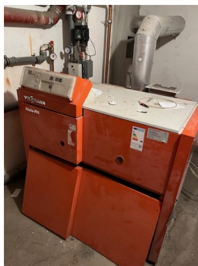
Die Gasheizung im Keller — Baujahr 1998. Fast 30 Jahre alt. Ersatzteile abgekündigt.
